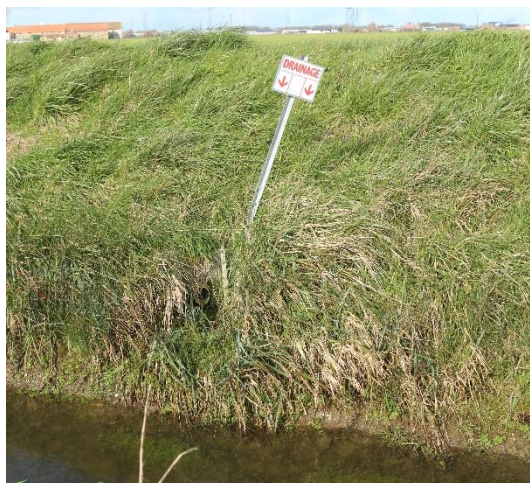
▲ Sortie de drain dans un Watergang
